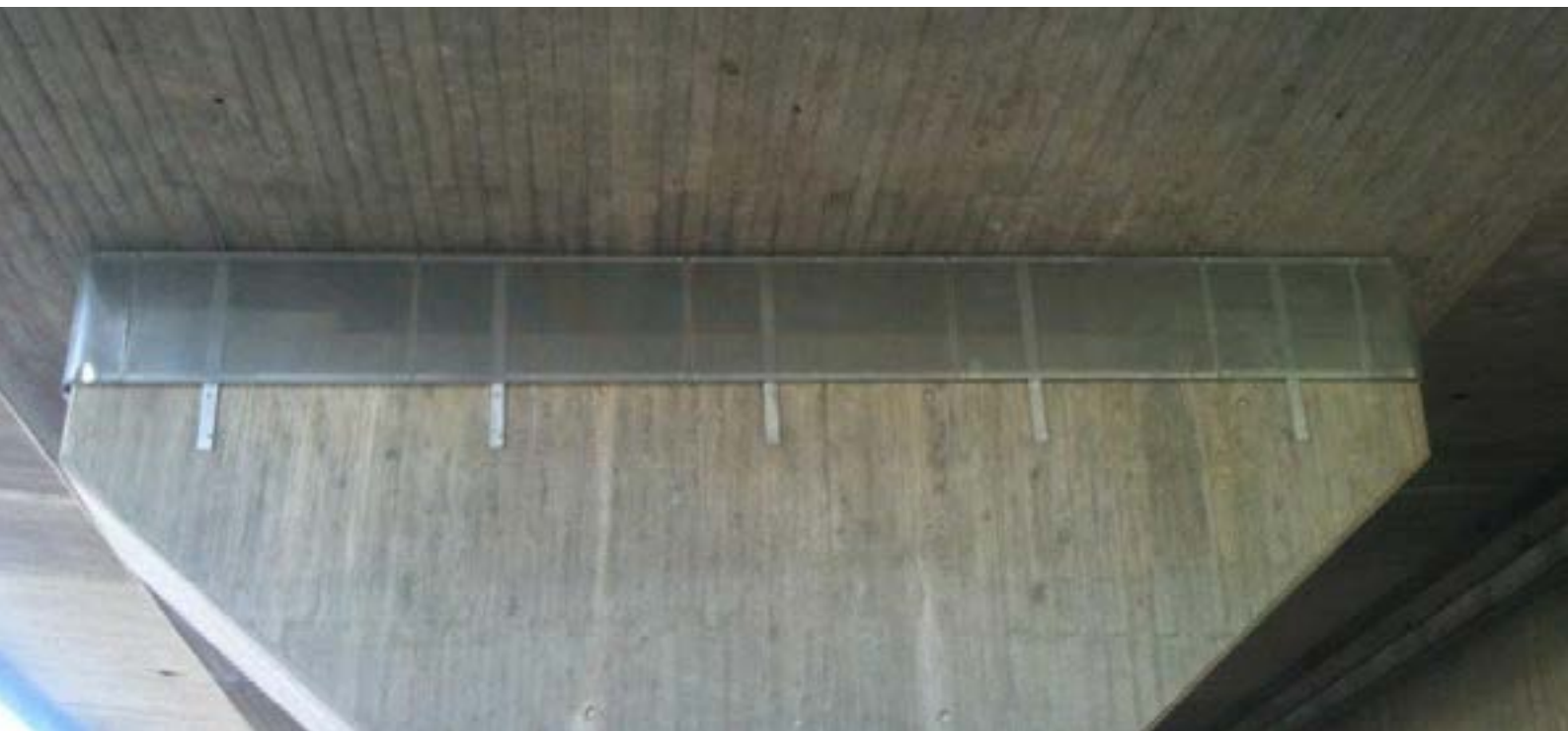
Schutz mit Lochblech-Platten
